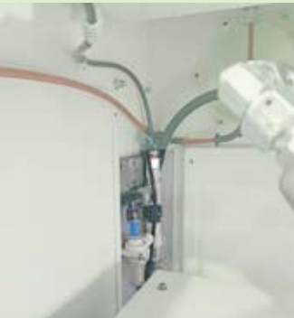
Vakuumerzeuger zusätzlich in der Maschine installiert
